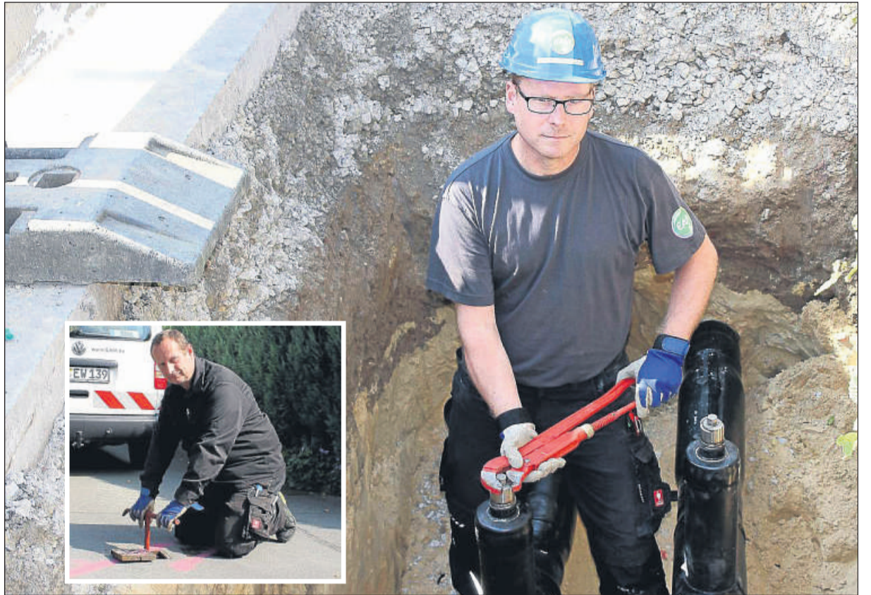
Fertig: Monteur Ingo Deppe und seine Kollegen haben die Arbeiten am Nahwärmenetz in Espenau schon nach zwei Tagen abgeschlossen. Dirk Schade zeigt, wie künftig die Ventile zugezogen werden können. Foto: Schippers
