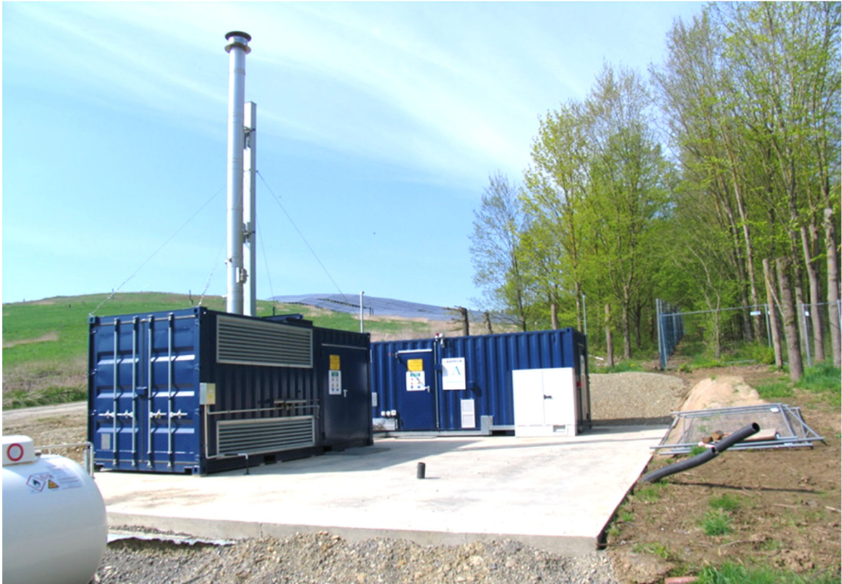
Abb. 2: Schwachgasverbrennungsanlage Deponie Kirschenplantage
