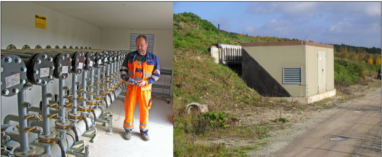
Abb. 3 - 30: Gasunterstation mit Einbauten (links)
