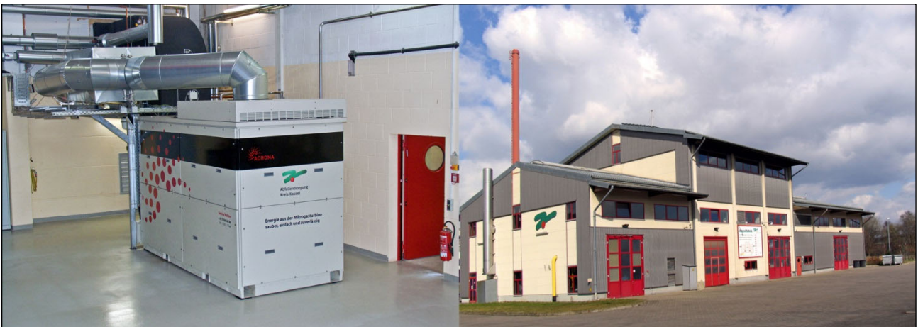
Abb. 3 - 33: Mikrogasturbine Capstone CR 200 im Gebäude der Umweltfabrik
