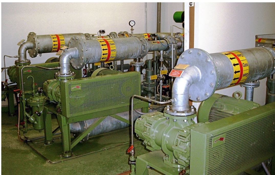
Abb. 3 - 31: Drehkolbenverdichter in der Verdichterstation
