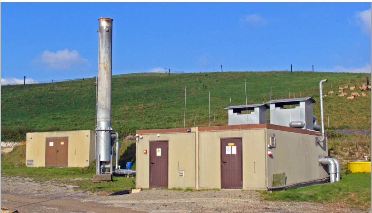
Abb. 3 - 35: Deponiegasmuffel, flankiert von der Verdichterstation (rechts) und der Gasunterstation 4
